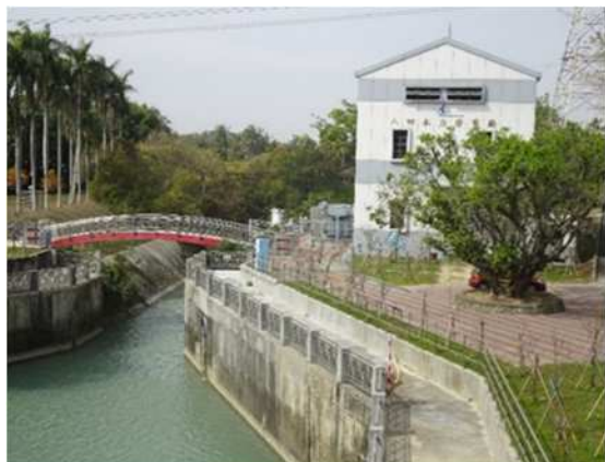
水力発電設備
